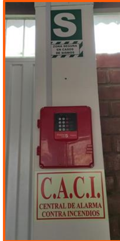
Nueva central de alarma contra incendios.
